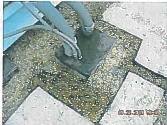
Area 10—Anomaly Clustered pipe conduits
